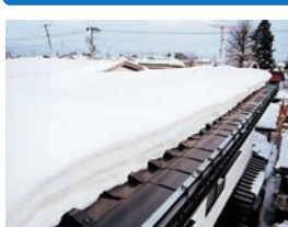
融雪屋根 設備
